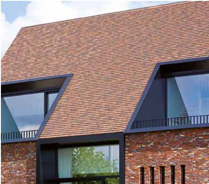
Tegelpan Aleonard Esprit Patrimoine mix van Noir de vigne, Noir de vigne intense & Vert de lichen - gevel: Terca Artiza Hectic CAAN architecten, Arch. K. Heijse - Gent
